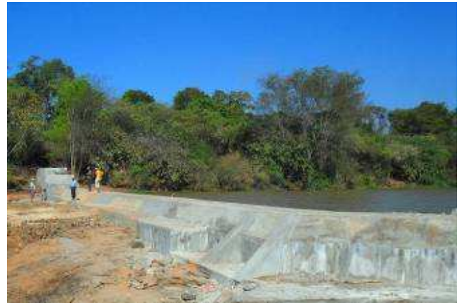
Barrage de déversoir de crue PI Tsarahotana
