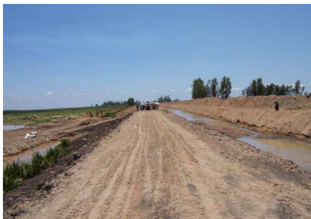
Figure 5 : Région Alaotra - Comblement d'une brèche et confortement de la digue d'Ambalanomby, Alaotra
